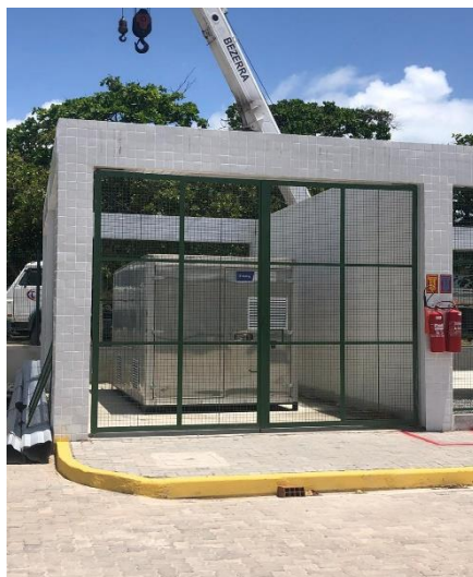
Instalação do Módulo de Ar Comprimido
